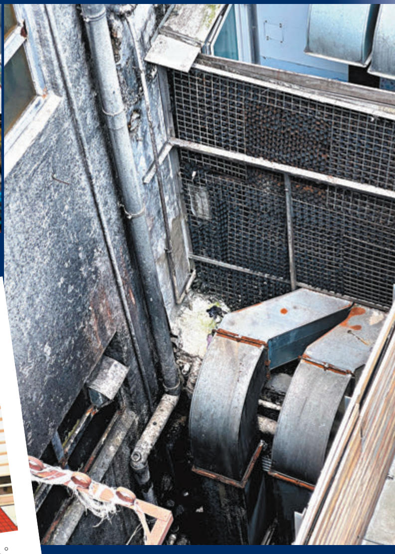
涉嫌違建的通風管道。香港文匯報記者攝
